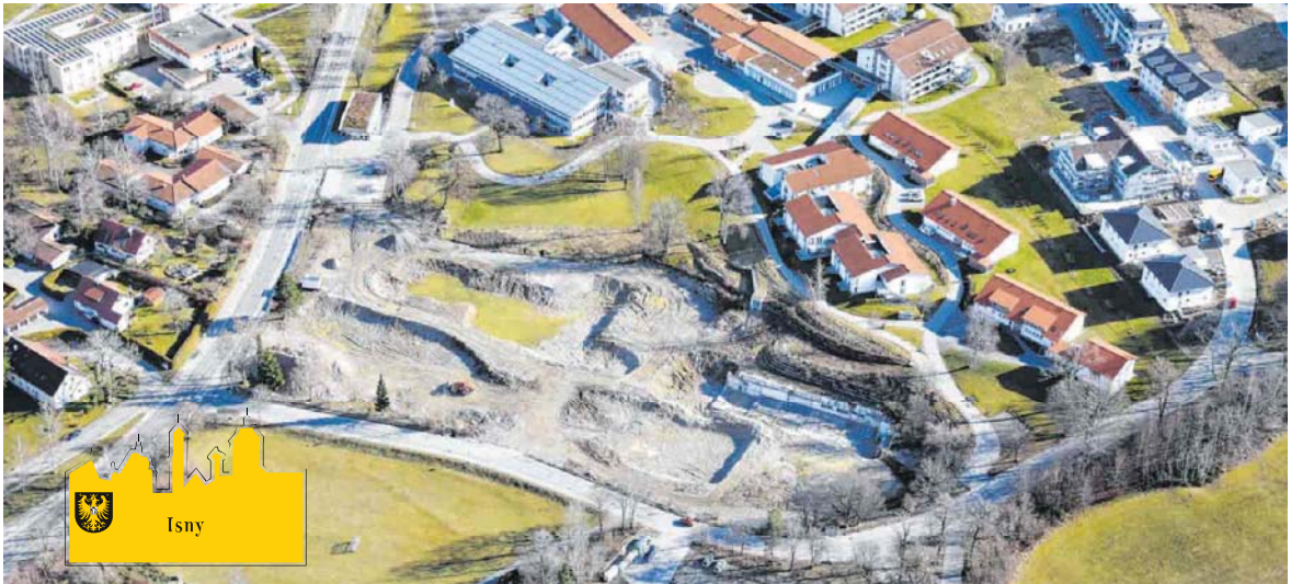
Das 18 Hektar große Areal nördlich des Stephanuswerks ist nahezu komplett abgeräumt – bis auf die Kellerwand der einstigen Rehaklinik, rechts in der Baugrube weiß zu erkennen. In diesem Bereich sollen auch die ersten vier Wohnblocks mit 64 Mietwohnungen entstehen. FOTO: HEINZ MAUCH
