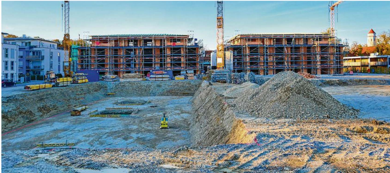
Die Bauarbeiten im Wohnpark Heilig-Kreuz-Straße in Kaufbeuren gehen voran. Jetzt begann der Bau weiterer Gebäude mit Mietwohnungen, für die bereits die Baugruben (Vordergrund) ausgehoben sind. Zudem feierten Handwerker, Bauherr, Planer und städtische Vertreter Richtfest an die Rohbauten (Hintergrund). Foto: Wild
